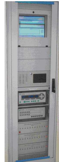
Fig. 9 Centrale di Monitoraggio IAQ
