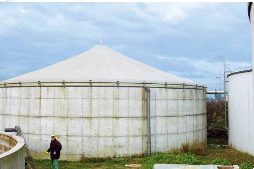
Foto 2 - Stoccaggio del digestato in un impianto di digestione anaerobica di liquame bovino, con in evidenza la cupola gasometrica per lo stoccaggio del biogas
