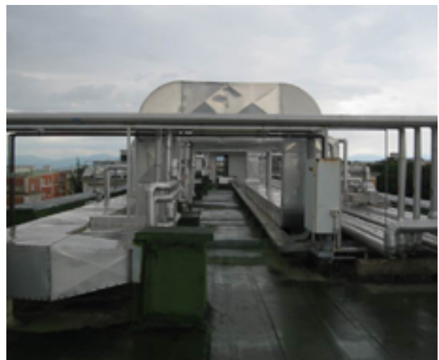
Unità di trattamento aria di un ospedale
