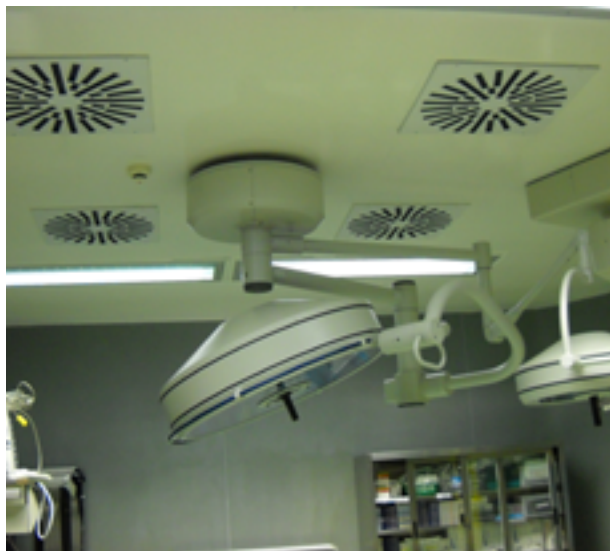
Diffusori a flusso elicoidale in sala operatoria
