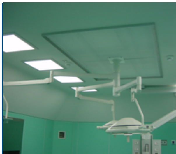
Diffusori a flusso laminare in sala operatoria
